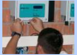
Anschluss eines Wechselrichters. Er wandelt Gleich- in Wechselstrom um.
